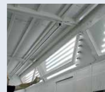
Hinged light fixtures for ease of cleaning and maintenance. Plafoneras en ángulo con bisagras para la limpieza y la manutención.
